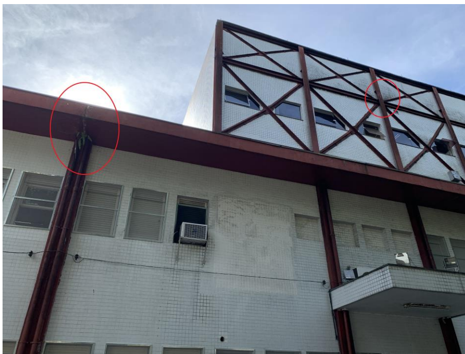
Figura 7 – Vegetação na junta de dilatação
