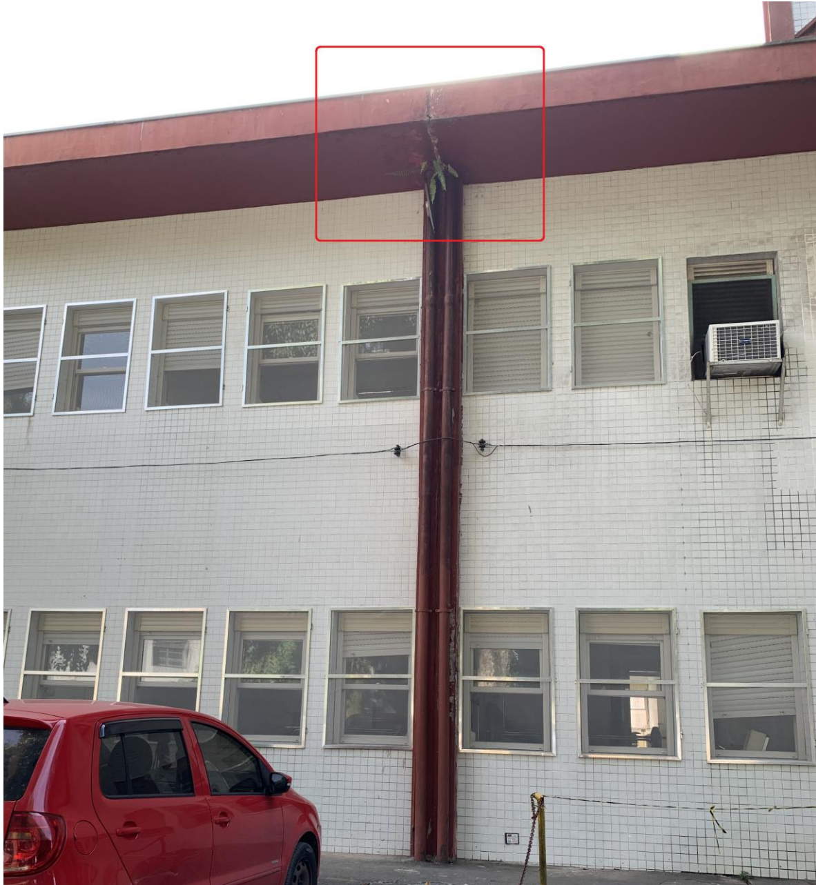
Figura 8 – Vegetação na junta de dilatação
