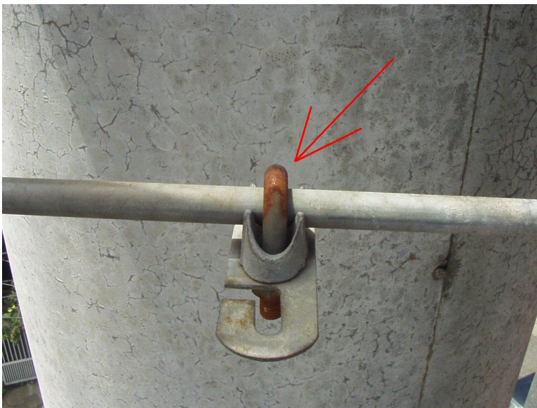
Figura 3 – Exemplo de Oxidação no Grampo “U” de Fixação do Cabo Trava-Quedas (sugere-se a troca)
