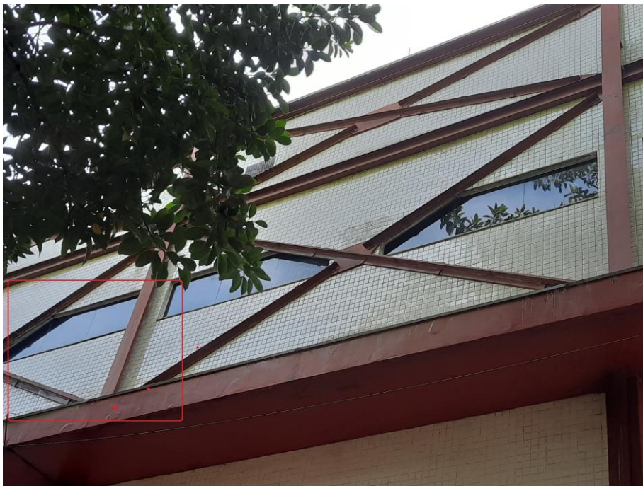
Figura 6 – Contraventamento metálico com um leve processo de oxidação
