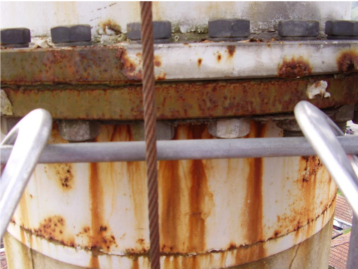
Figura 1 – Exemplo de Oxidação no Flange (sugere-se o tratamento)
