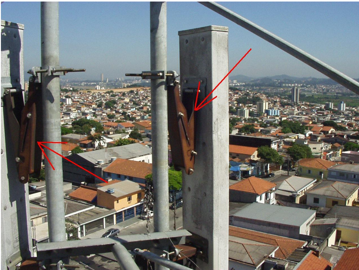
Figura 2 – Exemplo de Oxidação na Peça Metálica de Regulagem Zenital das Antenas de RF (sugere-se o tratamento)
