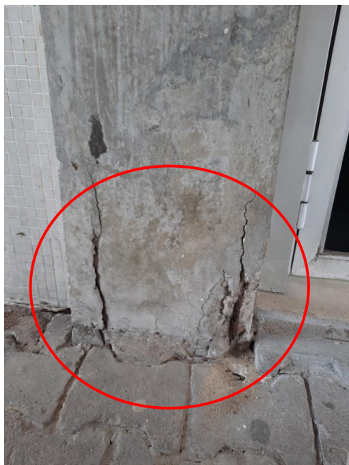
Figura 29 – Pilar com trincas e armadura exposta
