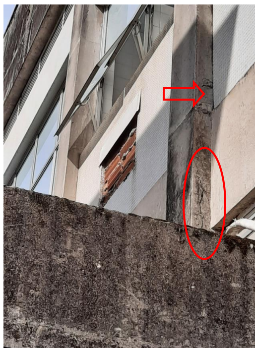
Figura 19 – Trinca e desprendimento de concreto em pilar
