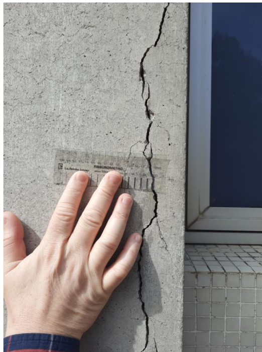
Figura 25– Trinca em pilar com abertura superior a 1,5 mm
