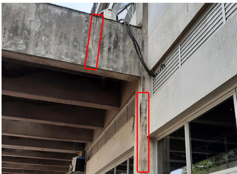
Figura 32 – Trincas na marquise e no pilar
