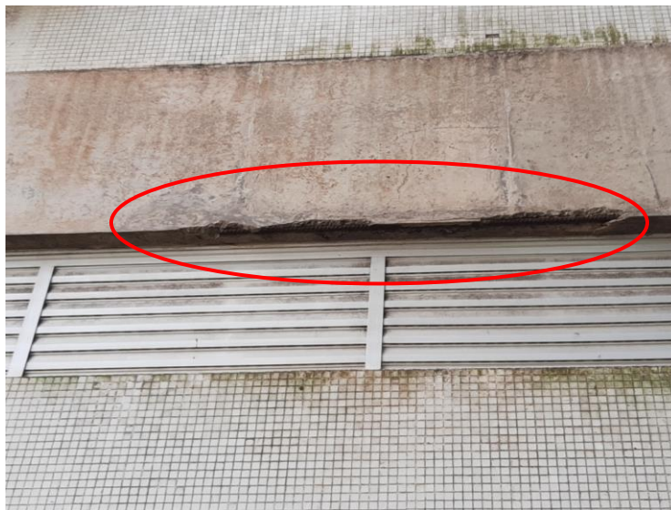
Figura 27 – Viga com armadura exposta
