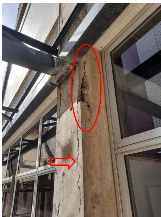
Figura 15 – Trincas, desprendimento de concreto e armadura aparente em pilar
