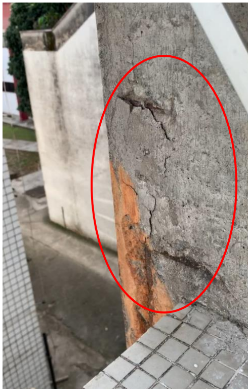
Figura 7 – Armadura exposta e diversas trincas em pilar
