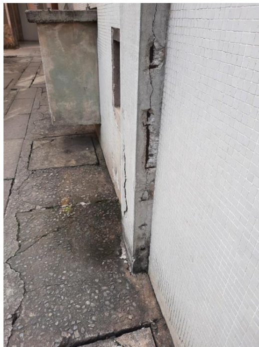
Figura 23– Pilar com armadura exposta e diversas trincas
