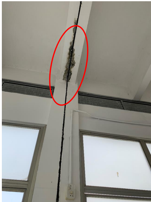
Figura 6 – Infiltração em pilar do 1º andar
