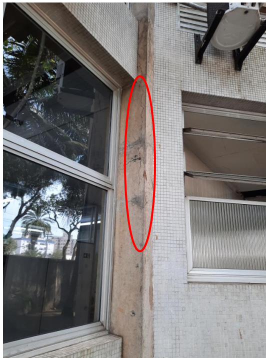
Figura 28 – Pilar com trincas e armadura exposta
