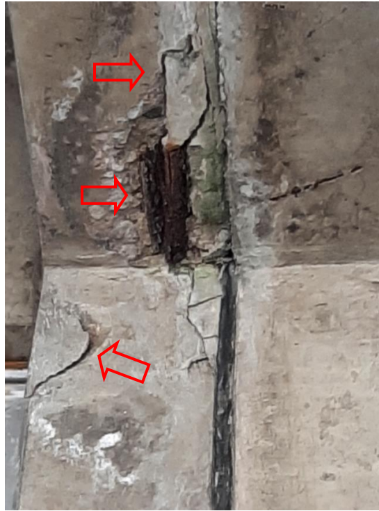
Figura 35 – Armadura exposta, diversas trincas e eflorescência (manchas brancas)
