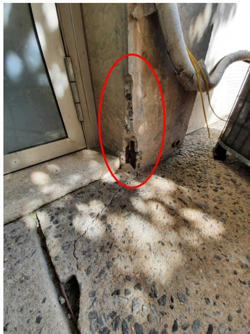
Figura 18 – Base do pilar com desprendimento de concreto e armadura exposta e oxidada
