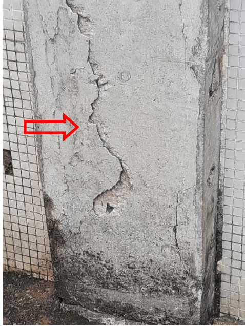
Figura 22 – Pilar com trincas
