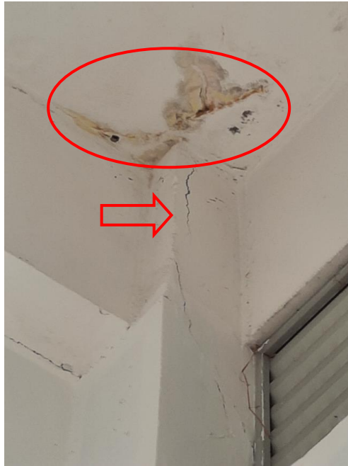
Figura 8 – Infiltração na laje e trincas em pilar do 1º andar
