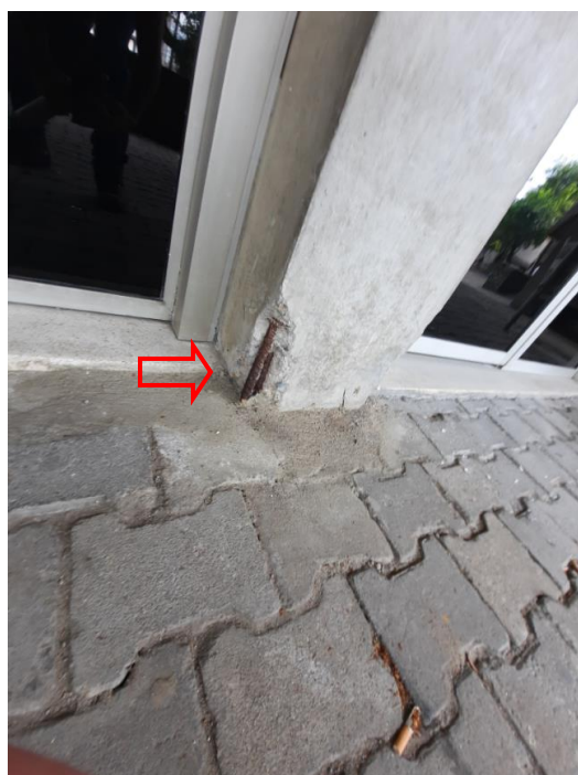
Figura 38 – Armadura exposta na base do pilar
