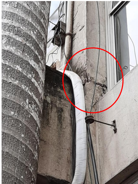
Figura 36 – Rachadura em pilar da marquise
