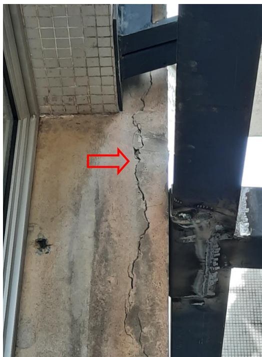
Figura 16 – Trinca em pilar
