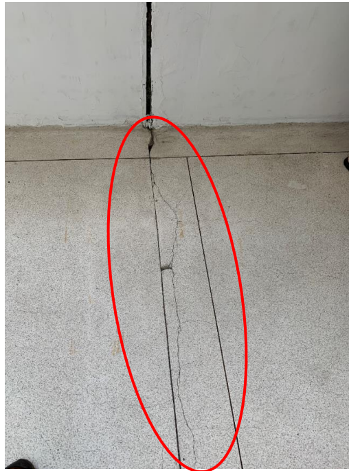
Figura 9 – Trinca no piso do 1º andar
