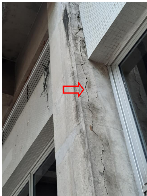
Figura 34 – Trinca em pilar da fachada
