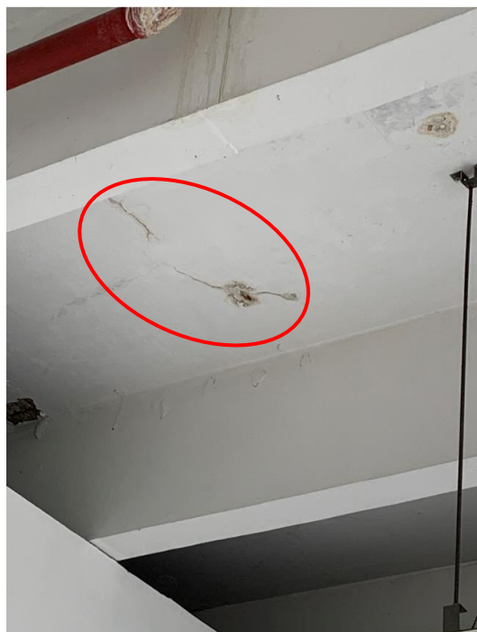
Figura 5 – Trincas na laje do 1º andar
