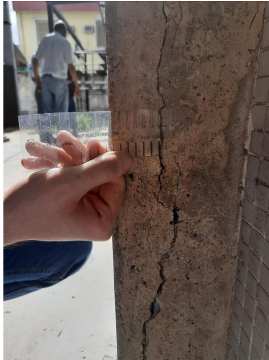
Figura 12 – Trinca em pilar
