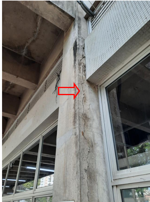
Figura 33 – Trinca em pilar da fachada
