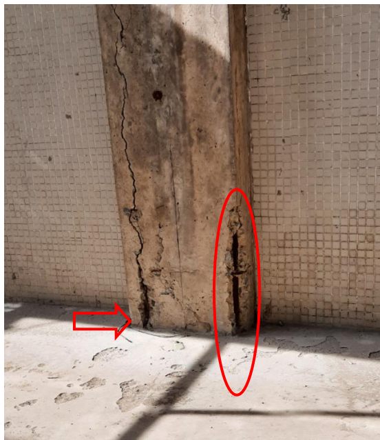
Figura 14 – Trinca e armaduras expostas em pilar
