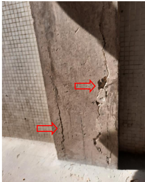
Figura 13 – Trinca e desprendimento de concreto em pilar
