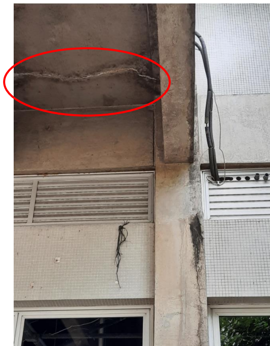
Figura 37 – Trinca na marquise com eflorescência (manchas brancas)
