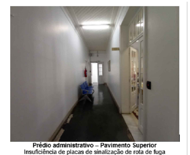
Prédio administrativo - Pavimento Superior Insuficiência de placas de sinalização de rota de fuga
