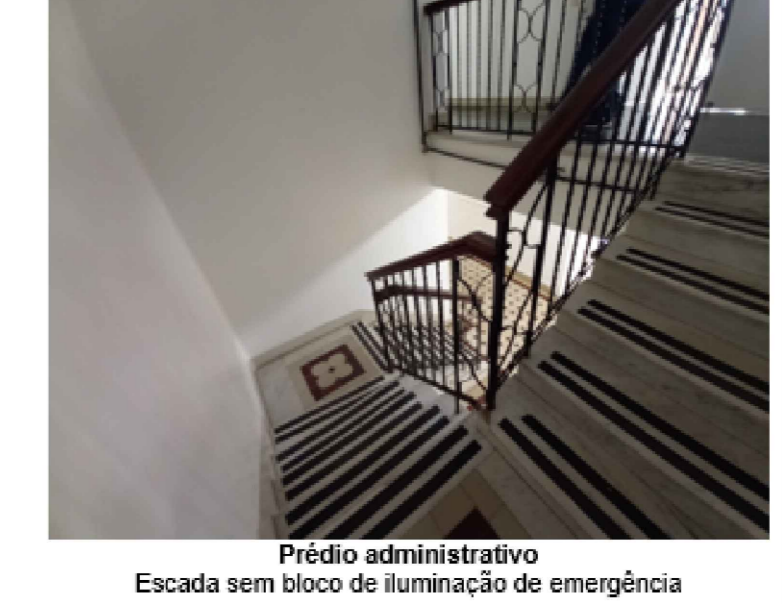
Prédio administrativo Escada sem bloco de iluminação de emergência
