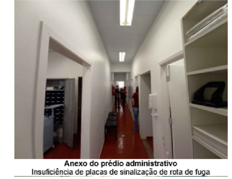
Anexo do prédio administrativo Insuficiência de placas de sinalização de rota de fuga
