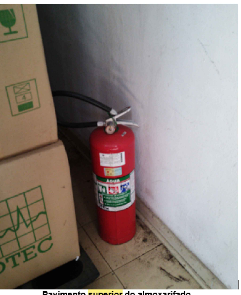
Pavimento superior do almoxarifado Equipamento obstruído por empilhamento de caixas
