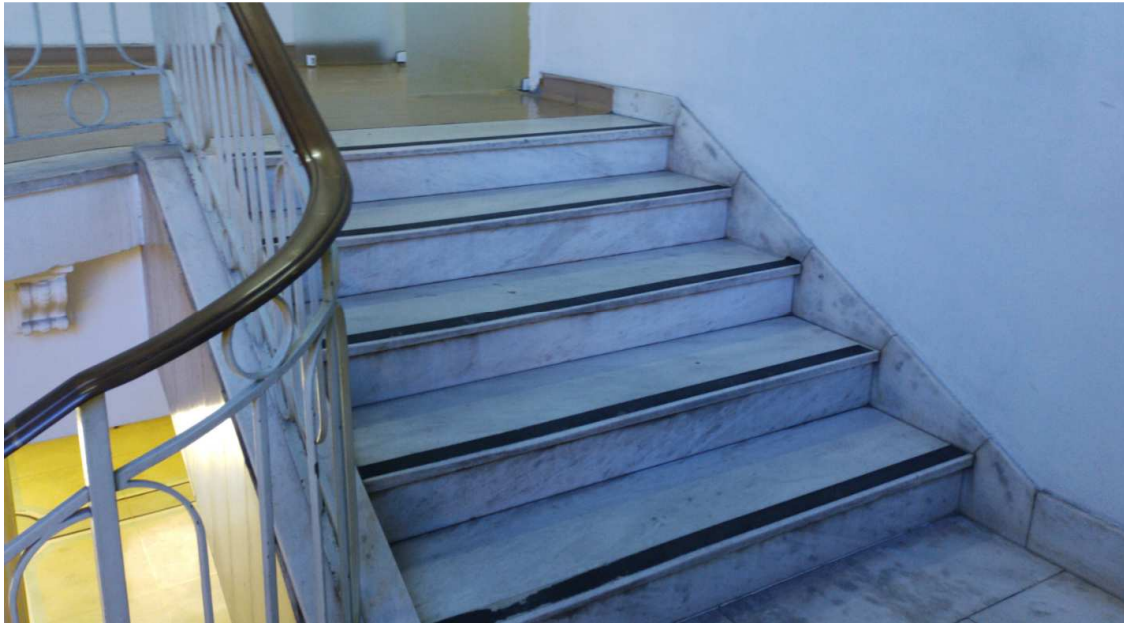
Figura 20 – IMAGEM ESCADA EXISTENTE – TRECHO 3 -DEMOLIR E RECONSTRUIR
